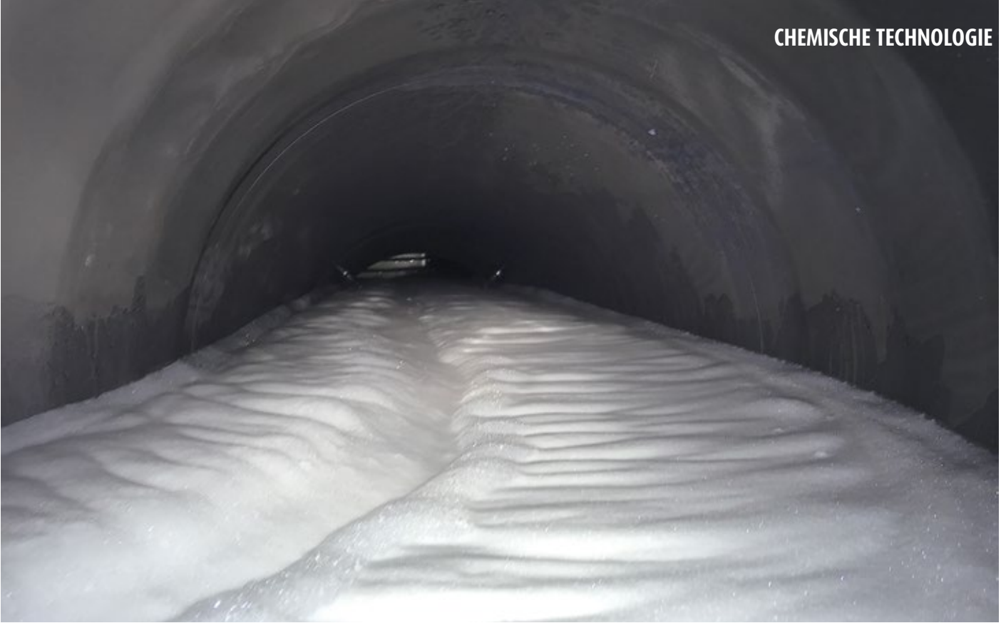
Abbildung 7: Schaum in Rohrleitung
